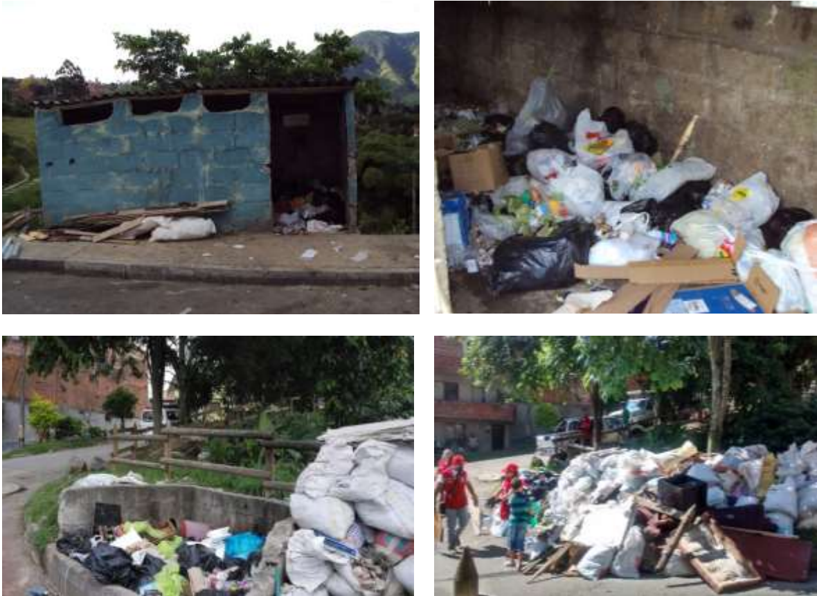
Fotografía 8. Infraestructura construida para acopio y presentación de residuos sólidos en zonas de difícil acceso
